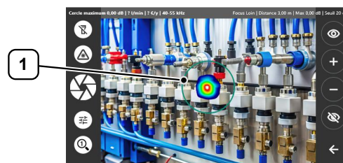
Figure 17: Fuite détectée de manière optimale (exemple)
