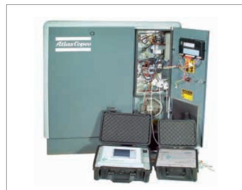
Beispiel: Messung am Kompressor
